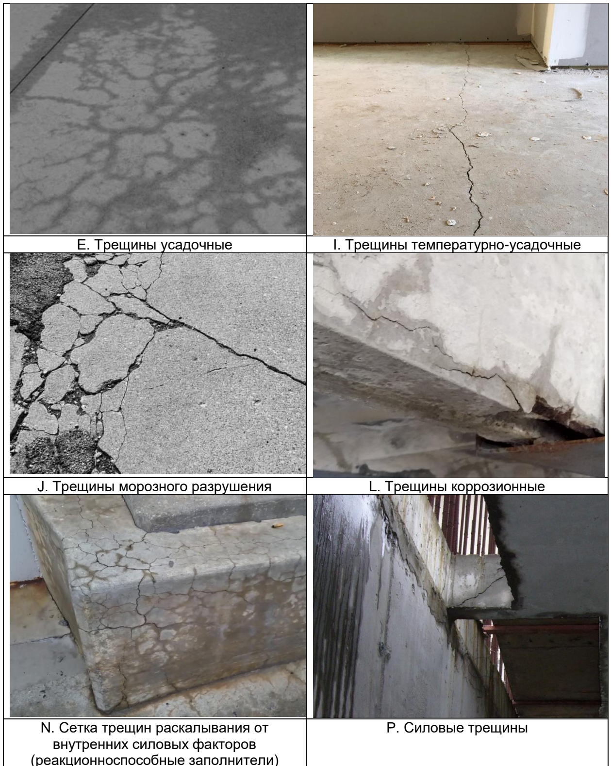
Рисунок Б.2 Характерные трещины в железобетонных конструкциях. Фотоизображения.
