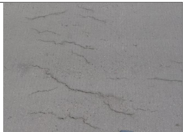
Д. Трещины усадочные
